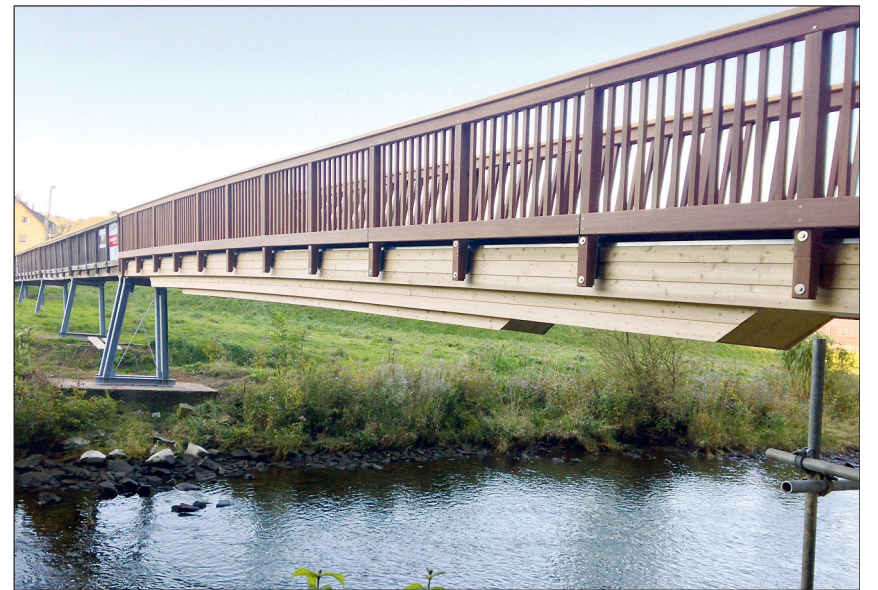
Das 20 m weit gespannte Hauptfeld der 1 m breiten Fußgängerbrücke „Lölsberger Steg“ in Overath wurde neu gebaut, der Bestand der fünf Brückenfelder im Vorlandbereich saniert. Das Tragwerk des großen Feldes ist ein blockverklebter, „abgestufter“ Fischbau-Träger mit oberseitiger Zinkblech-Abdeckung.
